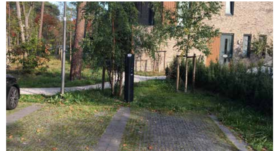
PARKEERPLAATSEN MET ELEKTRISCHE LAADPAAL
