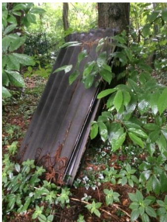
Figuur 8: Asbestverdachte golfplaten op het maaiveld
