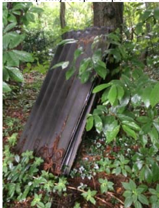
Figuur 6: Asbestverdachte golfplaten op het maaiveld
