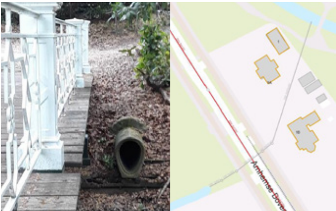
Foto: Inlaat van de duiker onder de Arnhemse Bovenweg, bij de brug over de vijver van Pavia. Kaart: Gemeente Zeist, 2019.
