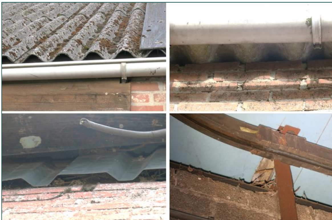
Figuur 3.2 Impressie van de openingen in de te slopen bebouwing die voor huismussen kunnen dienen als potentiële nestlocaties. Onderin zijn locaties in de bebouwing te zien waar nestmateriaal aangetroffen is dat mogelijk afkomstig is van huismusnesten.
