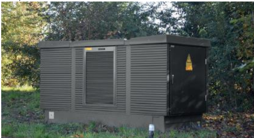
Figuur 9: Referentiebeeld transformatorstation
