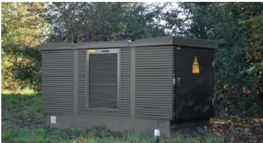
Figuur 7: Referentiebeeld transformatorstation
