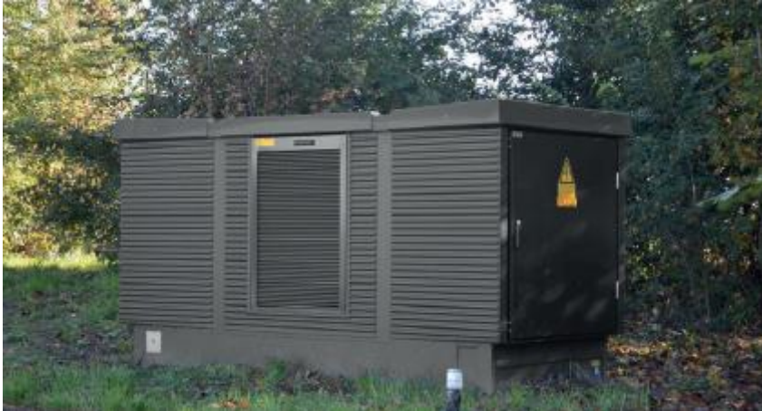
Figuur 7: Referentiebeeld transformatorstation
