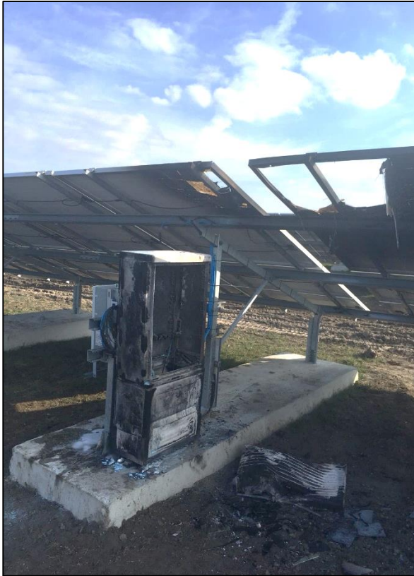
Figuur 7: Combiner box is uitgebrand
