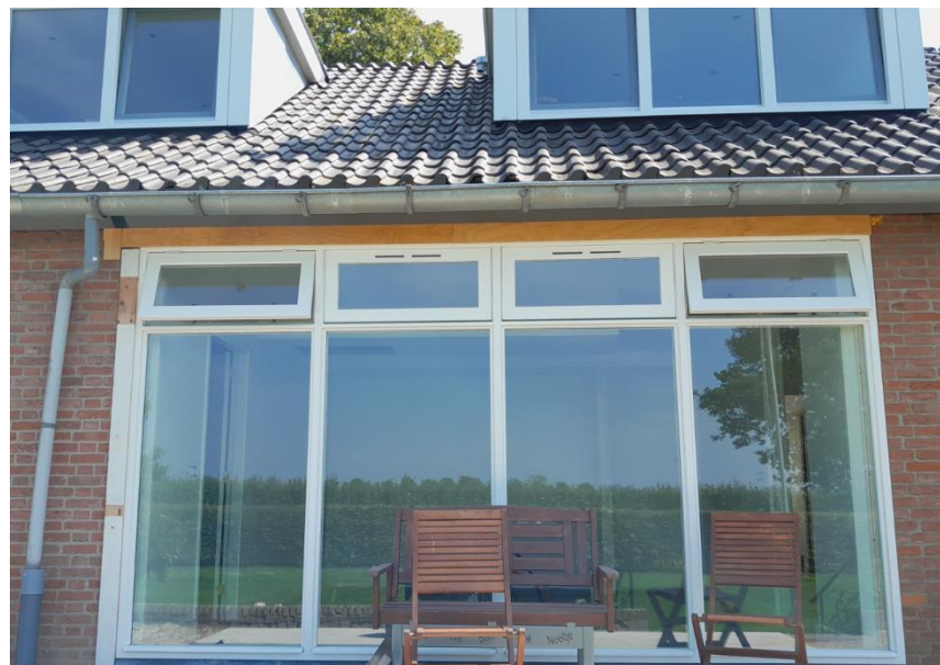
Figuur 8: westgevel met gebroken dakpannen
