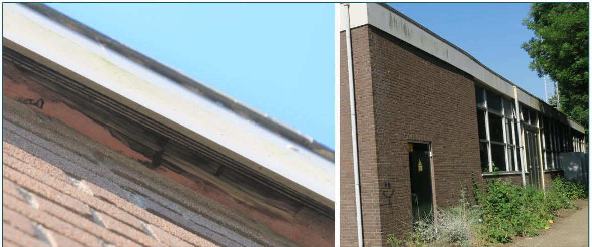
Figuur 3 Onder de boeiboorden bevindt zich een houten lat waardoor zich hier slechts enkele centimeters ruimte bevindt.
