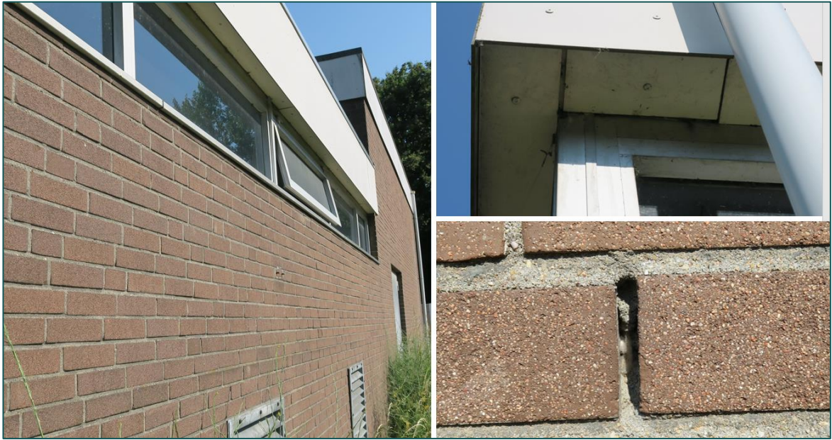
Figuur 4 Langs de gevel aan de oostzijde sluiten de boeiboorden overal strak aan. Op de plaatsen waar specie ontbreekt tussen de bakstenen is door de overige aanwezige specie geen sprake van een doorgang tot de luchtspouw.
