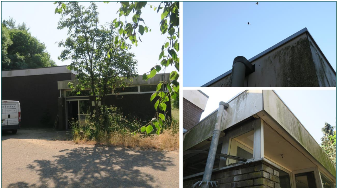
Figuur 6 Langs de gevel aan de westzijde is een bakstenen muur met boeiboorden en een uitbouw met glaswerk en boeiboorden aanwezig. Rechtsboven: opening welke naar een boomhommelnest leidt. Rechtsonder: grote opening aan de onderzijde van de boeiboorden van de uitbouw welke vrij spel biedt aan weersinvloeden.
