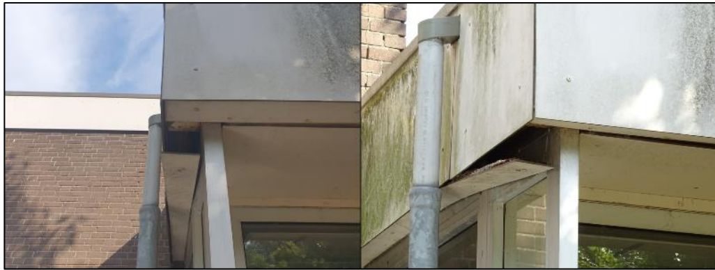
Figuur 4 De loshangende plank aan de onderzijde van een boeibord ten noorden van de entree.
