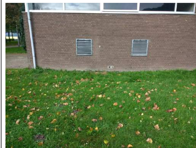
Figuur 3: Waarschijnlijk verwijderd vulpunt ondergrondse tank
