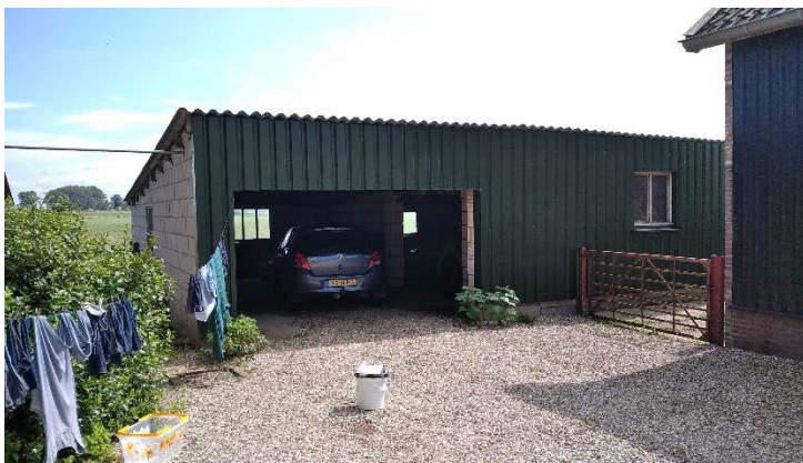
Schuur 4 (asbest verdacht dak)
