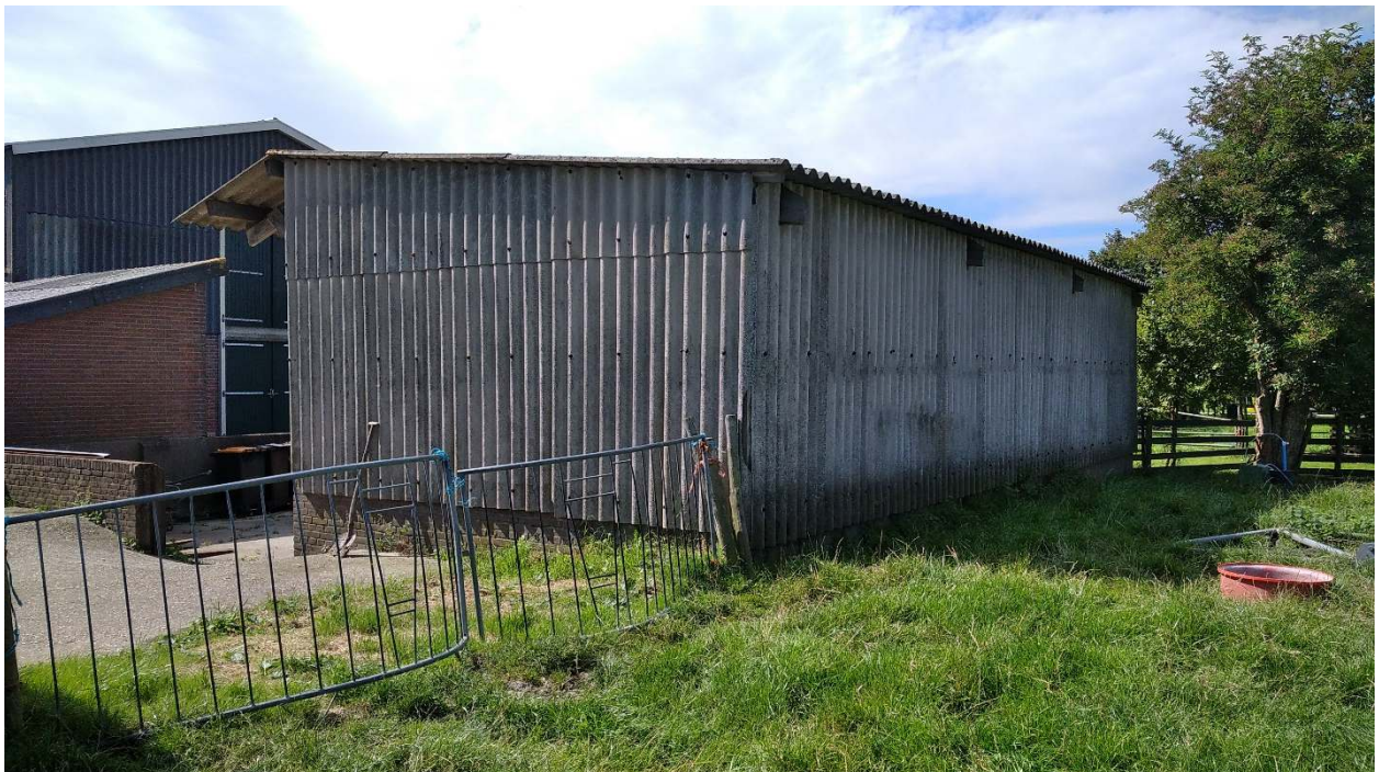
Schuur 1 (asbest verdacht dak)
