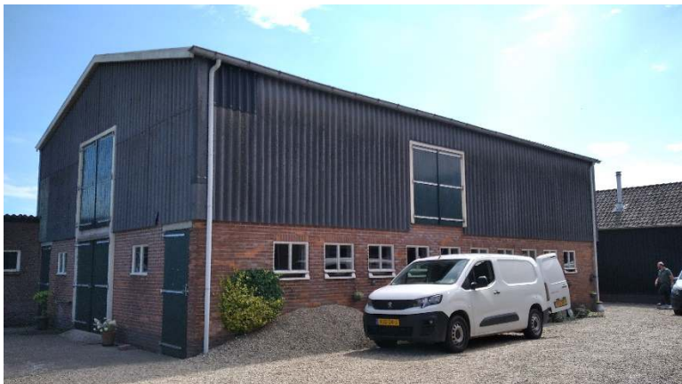
Schuur 3 (asbest verdacht dak)
