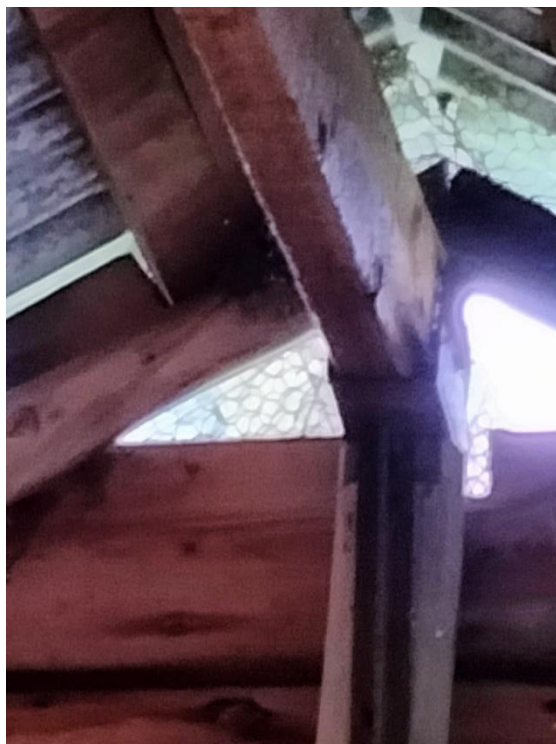
Foto 12: nok is dicht gemaakt met gaas
