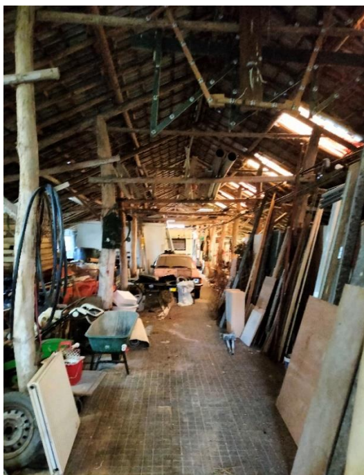
Foto 3: binnenzijde geen dakbeschot
