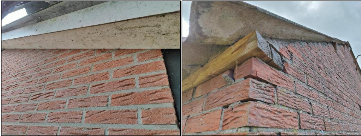
Foto links; strak aansluitende daklijsten tegen metselwerk. Foto rechts; golfplaten op cement op muur gelegd.
