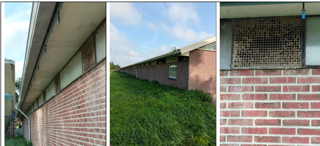
Foto van beide zijgevels, er zijn geen openstootvoegen aangebracht, de openingen zijn voorzien van gaas.
