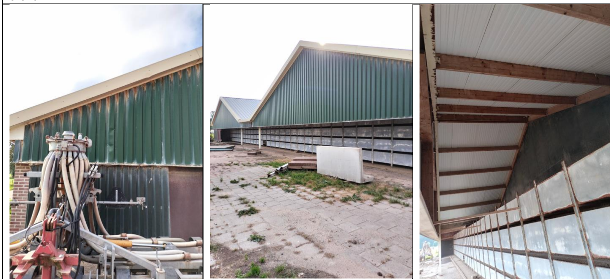
Foto's van de achterzijde, waar ook de mest afvoerband zichtbaar is.
