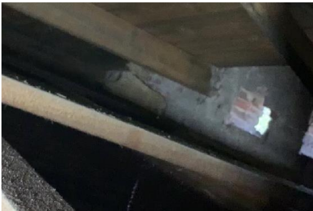
Figuur 14; detailfoto van de vliering; te zien zijn de dakconstructie en de grote tochtgaten in de gevels
