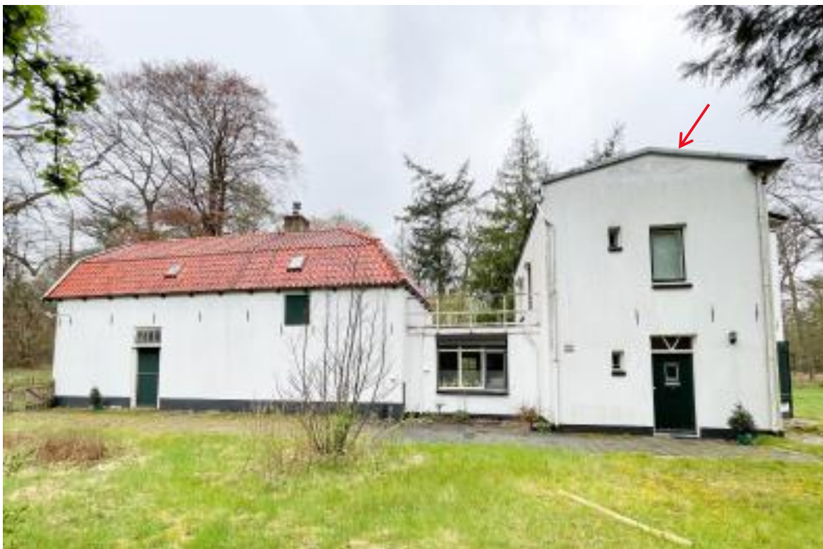
Figuur 17; zijaanzicht pand. Te zien zijn de afgedichte tochtgaten van de vloering in de gevels van het voorhuis (rode pijl). Foto: Staatsbosbeheer
