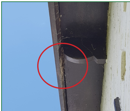
Afb. 2.3: Onder het dak aan de westkant broedt een vogel. Binnen de rode cirkel zijn vogelpoep en nestonderdelen te zien. Ook hier zijn spleten te zien welke toegang kunnen dienen voor vleermuizen.
