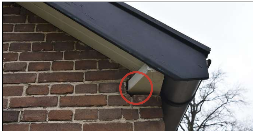
Figuur: het woonhuis heeft op verscheidene plaatsen kieren langs de dakrand. Hier kunnen vleermuizen in kruipen. Deze mogelijke verblijfplaatsen zullen niet vernietigd worden, maar er kunnen wel negatieve effecten optreden door trillingen en lichteffecten.
