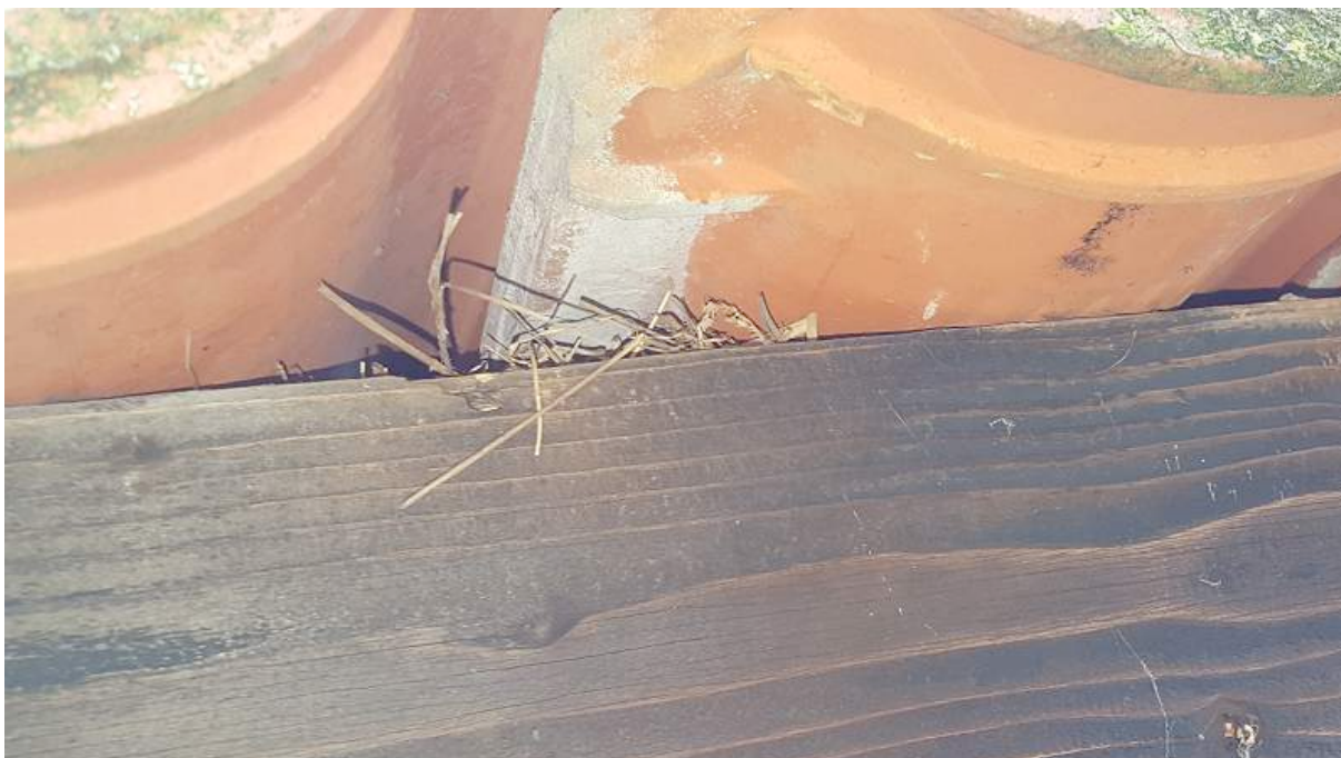
Afbeelding 4: Nestmateriaal onder het dak met dakpannen, er werd op meerdere plaatsen onder dit dak nestmateriaal waargenomen. Foto: B. Verhoeven | Ecoresult B.V.
