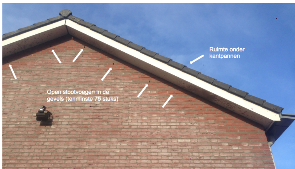
Figuur 2 In alle gevels van het schoolgebouw zijn open stootvoegen aangetroffen. Middels deze openingen kunnen vleermuizen in de spouwruimte kruipen.
