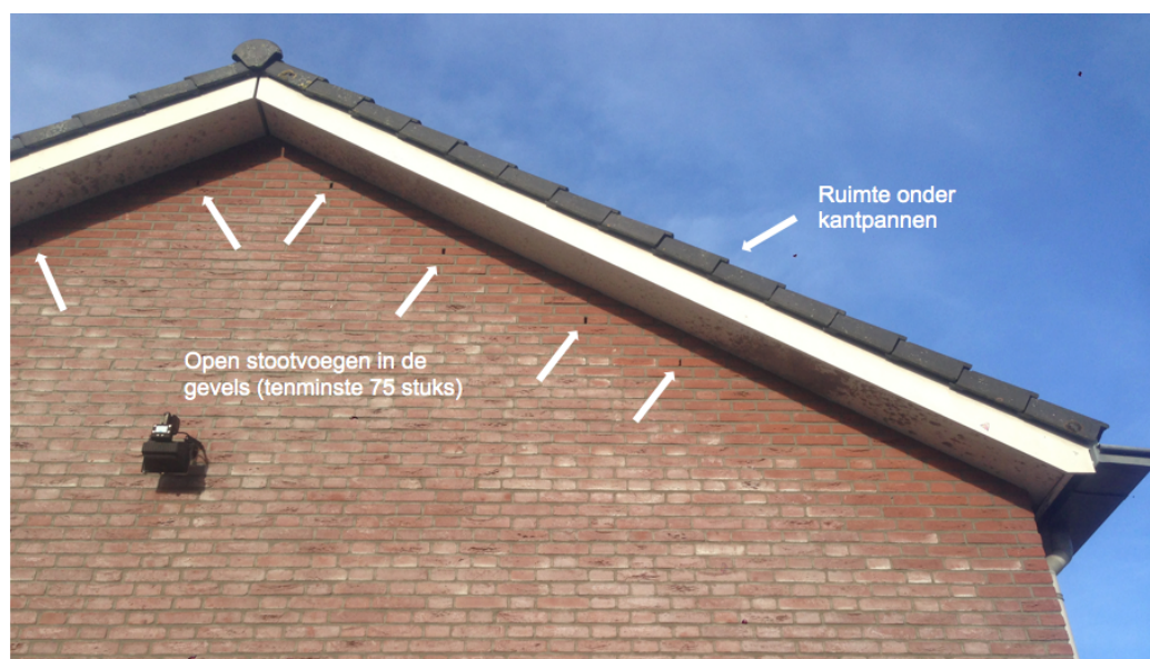
Figuur 1 In alle gevels van het schoolgebouw zijn open stootvoegen aangetroffen. Middels deze openingen kunnen vleermuizen in de spouwruimte kruipen.
