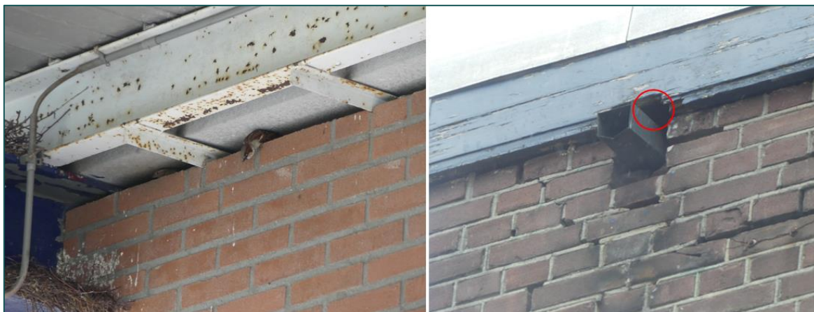
Figuur 3.2 Onder de overkapping aan de achterkant van het nieuwbouwgedeelte zijn huismusnesten aangetroffen (links). Gierzwaluwen kunnen nesten maken in openingen bij regenpijpen (rechts). Deze foto betreft de stripperij.
