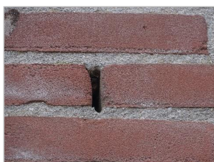
Foto 30: Kleine smalle stootvoegen (ontoegankelijk).
