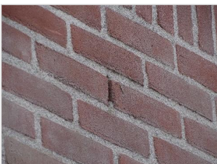
Foto 28: Kleine smalle stootvoegen (ontoegankelijk).
