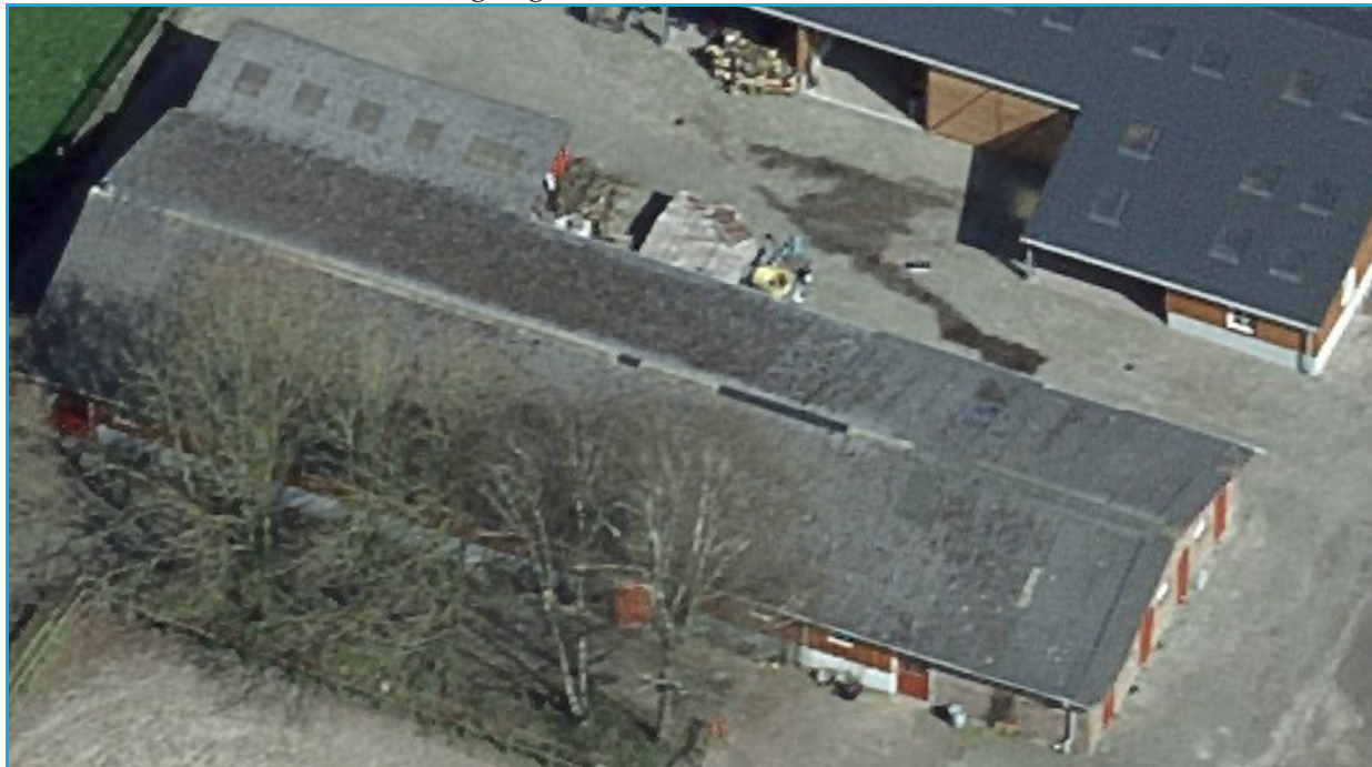
Foto 1: schuur met asbestdakbedekking en goten
