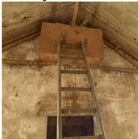
Uilenkast in gebouw 9a
