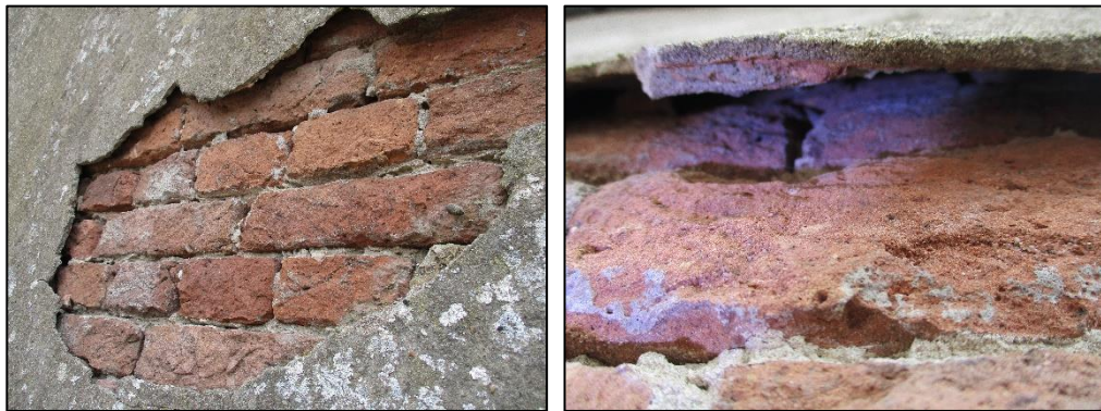
Figuur 4 Opening in het pleisterwerk van de grote schuur.
