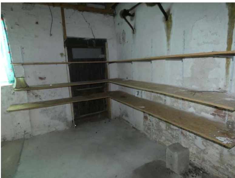
De doorgang naar het boenhok is onbruikbaar geworden omdat in de hoek van de wagenschuur (kaas)planken zijn aangebracht. Tegen de bovenzijde van de wand de katrollen voor snaaraandrijving van machines.
