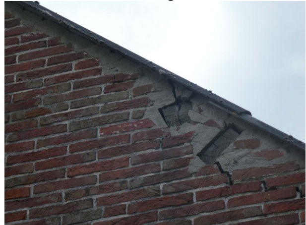
Figuur 16 Scheuren in de muur van de varkensschuur
