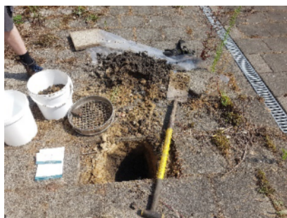
Afbeelding 6: inspectiegat onder tegel
