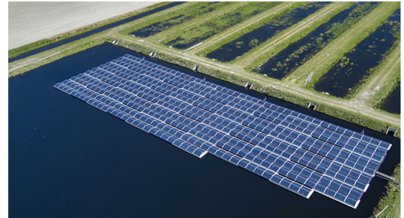
Afbeelding 8. Drijvend zonnepark bij RWZI Everste Koog op Texel, bestaande uit circa 800 zonnepanelen (circa 0,2 MWp). Gerealiseerd in 2016 door het hoogheemraadschap (HHNK), coöperatie TexelEnergie 18 en gemeente Texel. De drijvende zonnevijver voorziet de gehele Texelse openbare verlichting van stroom.
