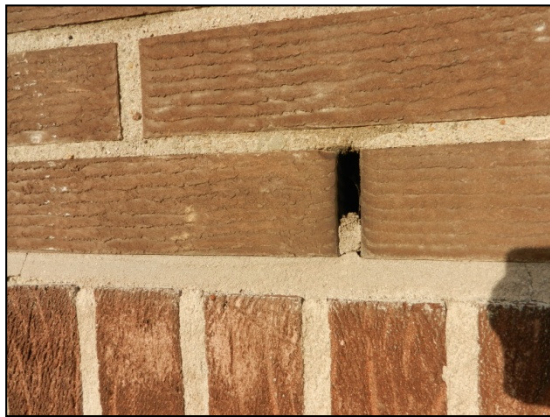
Figuur 4. In het pand bevinden zich open stootvoegen die aan vleermuizen toegang kunnen verlenen tot de spouwruimte.
