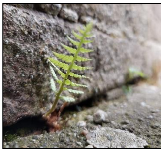
Figuur 5.2. Blaasvaren langs zuidwestgevel van noordelijke luchtplaats.
