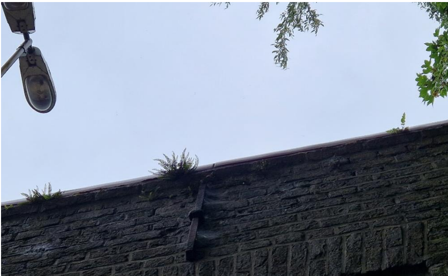
Figuur 4.1 Groeiplaats van steenbreekvaren bovenaan de buitenmuur (oostzijde bebouwing).
