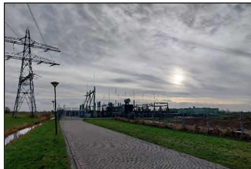
Figuur 2.4. Hoogspanningsstation met mast 13.
