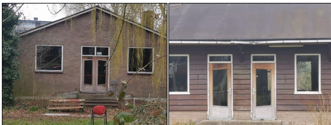
Figuur 2.5 (links): Impressie van de oostelijke zijde van het gebouw; Figuur 2.6 (rechts): Impressie van de gevelbetimmering, deze vertoont enkele kieren.
