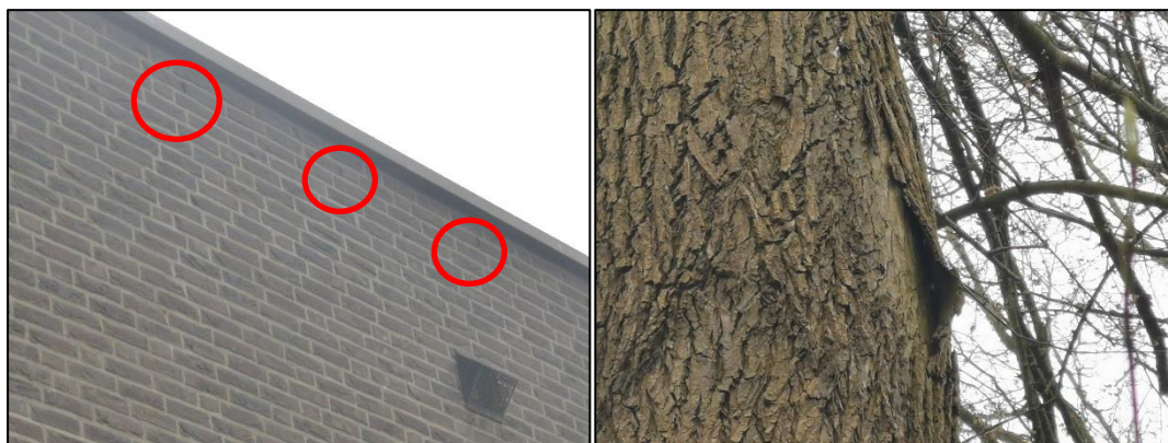
Figuur 6.4: Open stootvoegen in het plangebied; Figuur 6.5: Loszittend schors van een boom aan de Manegelaan.
