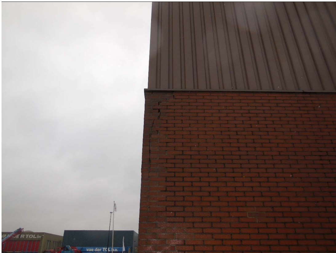
Figuur 2.3 Spleten en gaten in de spouwmuur van het meest noordelijk gelegen gebouw.
