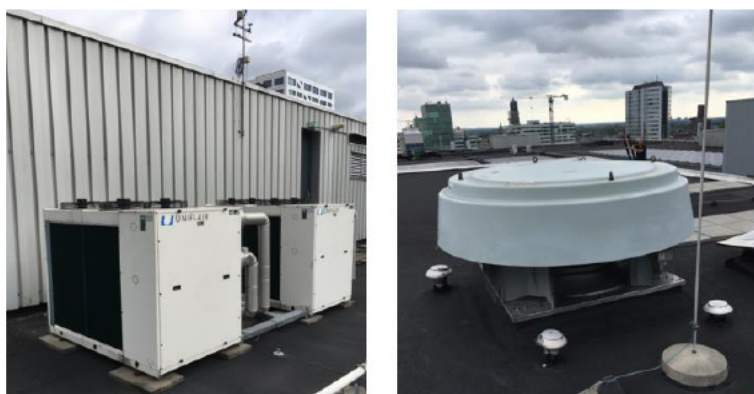
Figuur 2: Koeling computerruimte (bronnr. 367) en ventilator dakopbouw (bronnr. 1001)
