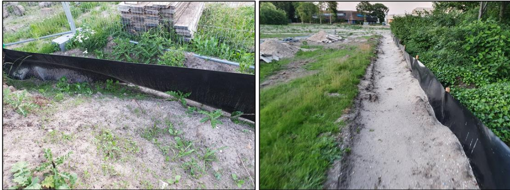
Figuur 3 Een incorrect geplaatst amfibiescherm (links). Een correct geplaatst amfibiescherm (rechts). Deze dienen minimaal 10 cm ingegraven te zijn.
