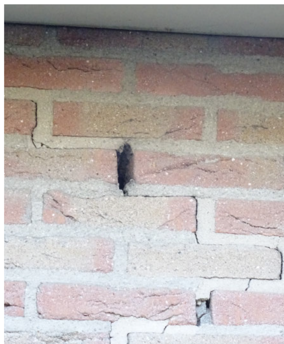
Afbeelding 6. Één van de open stootvoegen die voor vleermuizen potentieel toegang verschaft tot de spouwmuren.
