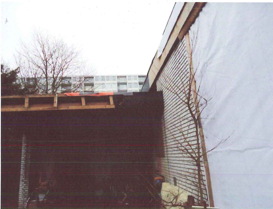
Zicht op het schoolgebouw vanaf de zijde van de Nigerdreef. Het gebouw is ongeschikt voor vleermuizen door de tochtige openingen in de betimmeringen.
