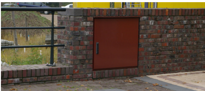
e-kasten in bebouwing geïntegreerd
