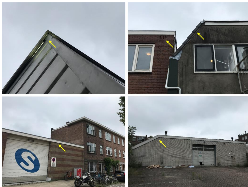
Figuur 5 Op de planlocatie is sprake van potentieel geschikte invliegopeningen en verblijfplaatsen van gebouwbewonende vleermuissoorten.
