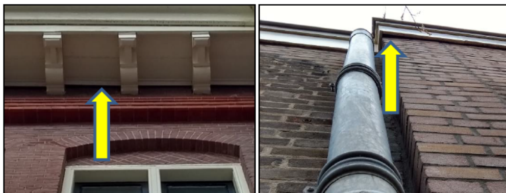
Ruimte tussen muur en omtimmering van dakgoot bij de binnentuin (links) en tussen de muur en omtimmering bij de loods aan de zuidzijde (rechts).
