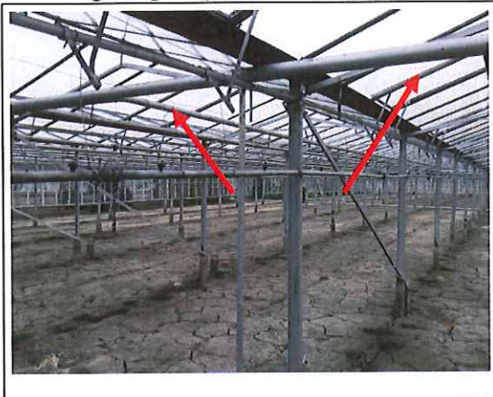
Foto 7: binnenzijde "kas 1955" met asbesthoudende beglazingskit (item 3: M3) bij dak
