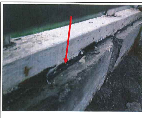
Foto 6: asbesthoudende beglazingskit (item 3; M3) op opstand "kas 1955"
