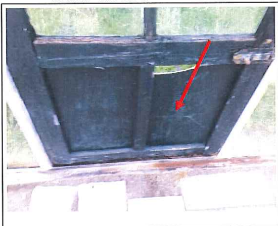
Foto 13: asbesthoudend plaatmateriaal (item 6: M6) in deur "kas 1974"
