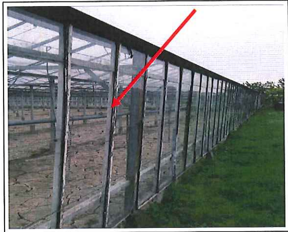
Foto 10: buitenzijde "kas 1974" met asbesthoudende beglazingskit (item 5: M5)
