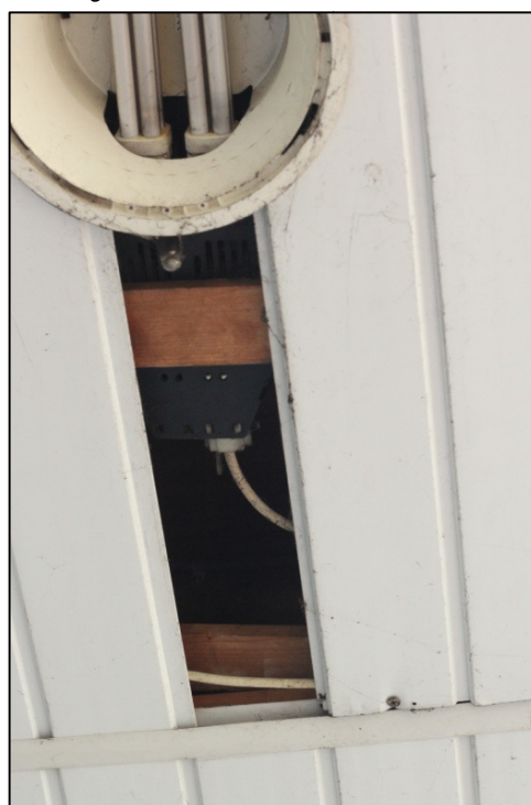
Foto 6: toegang tot binnenkant gebouw door achterstallig onderhoud
