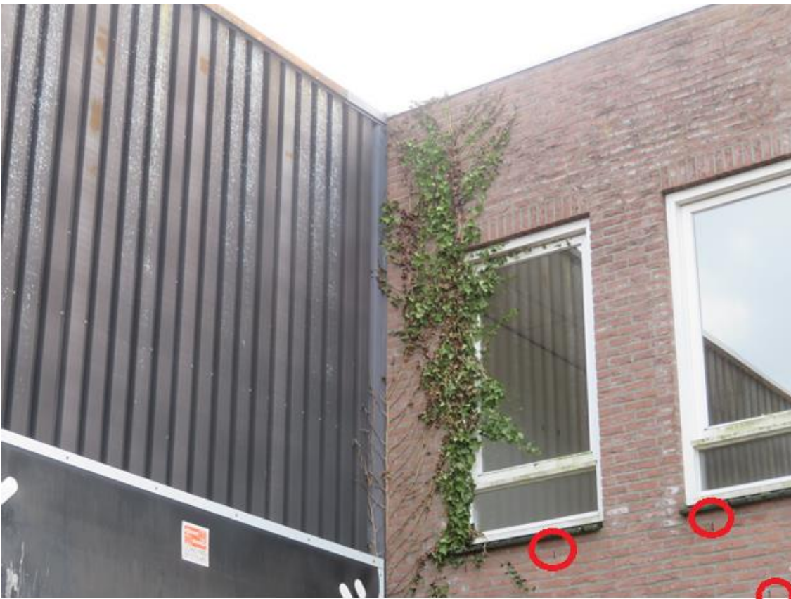
Enkele van de aanwezige open stootvoegen in gebouw 3.
