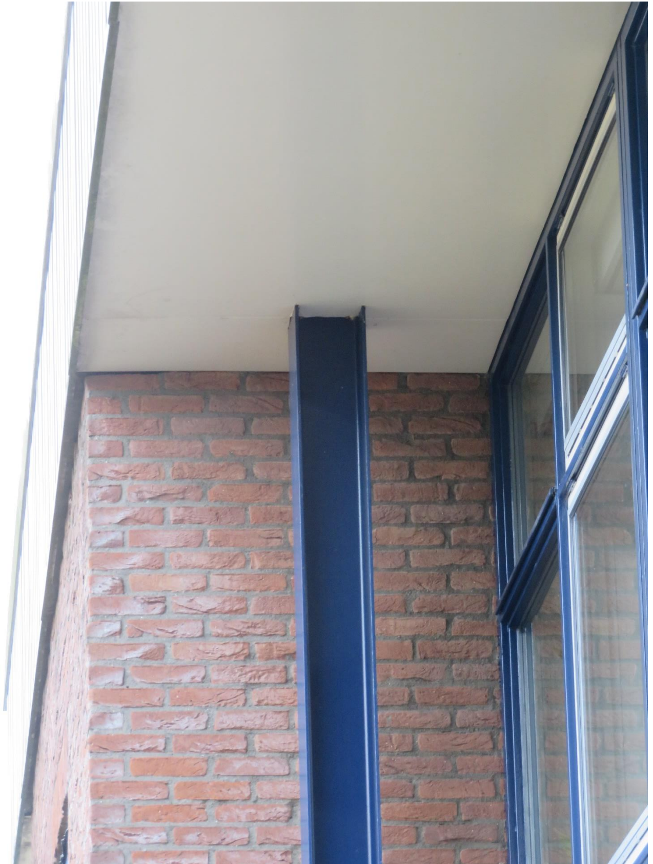
Aansluiting zonder kieren tussen kozijn en dakbetimmering van kantoor gebouw 1
