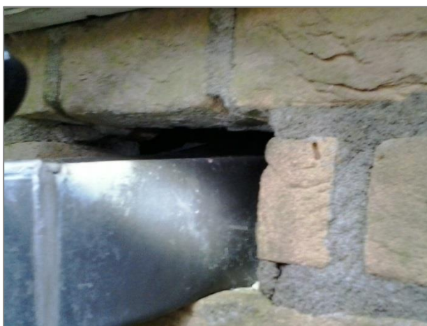
Foto 12 | Door de opening boven de regenpijp toegang tot een mezenestje in het langgerekte bedrijfspand
