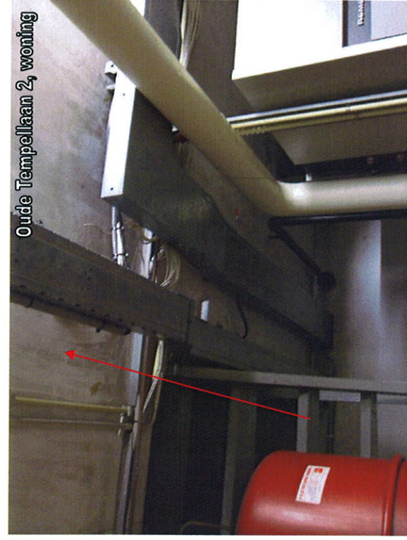
Foto 2: de plafondplaten in de Cv ruimte in de kelder (Abm/002)
