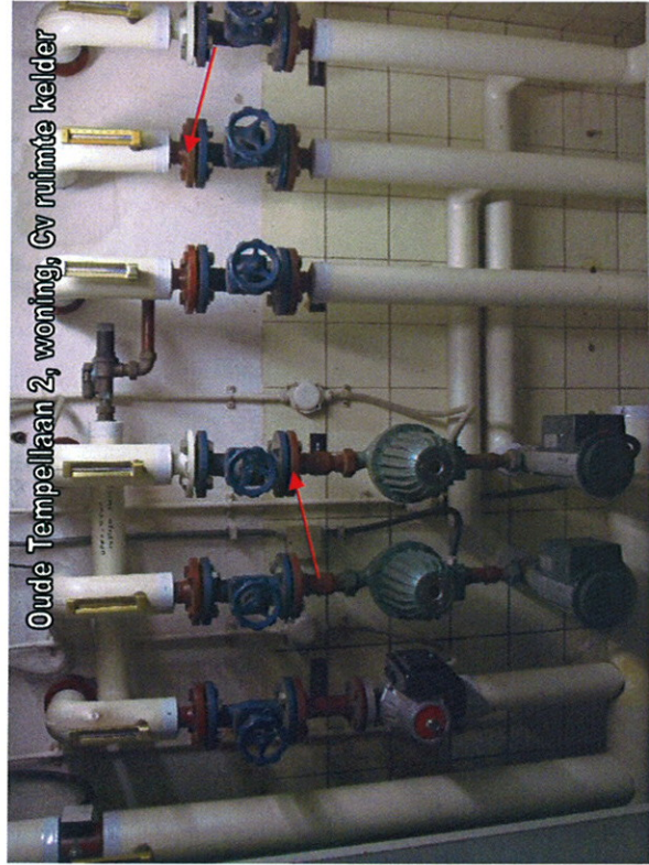
Foto 7: (mogelijk) asbesthoudende pakkingen in het leidingstelsel (P)
